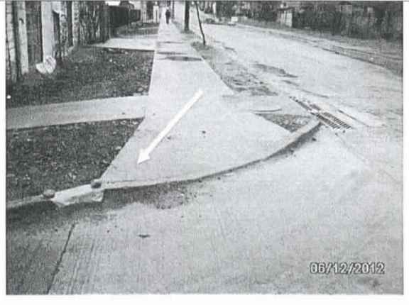
FOTO N° 7 GRIETA EN DISPOSITIVO DE RODADO
