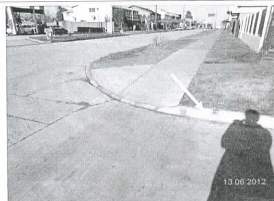
FOTO N° 35 DEFICIENTE INSTALACION DE SOLERAS
