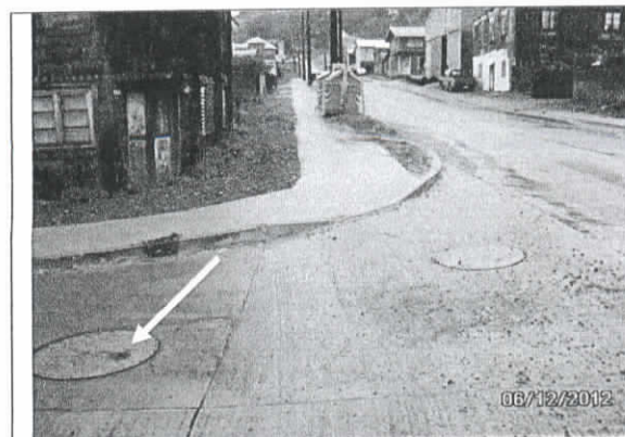
FOTO N° 11 TAPA CÁMARA CON HORMIGÓN DEFICIENTE
