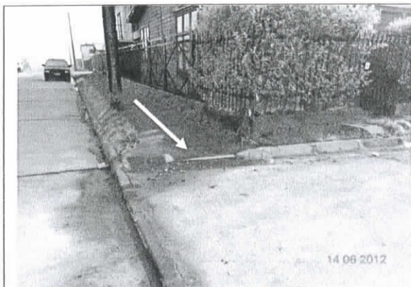
FOTO N° 24 DEFICIENTE DISPOSITIVO DE RODADO
