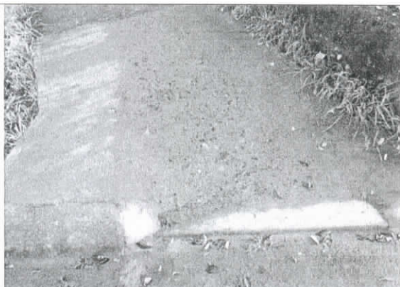
FOTO N° 25 DEFICIENTE DISPOSITIVO DE RODADO
