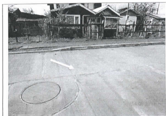
FOTO N° 28 FISURA EN LOSA DE PAVIMENTO
