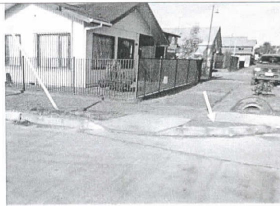
FOTO N° 33 DEFICIENTE INSTALACION DE SOLERAS
