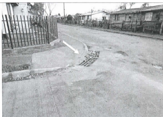
FOTO N° 27 DISPOSITIVO DE RODADO SOBRE SUMIDERO
