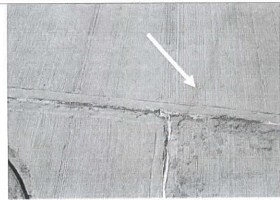
FOTO N° 29 FISURA EN LOSA DE PAVIMENTO
