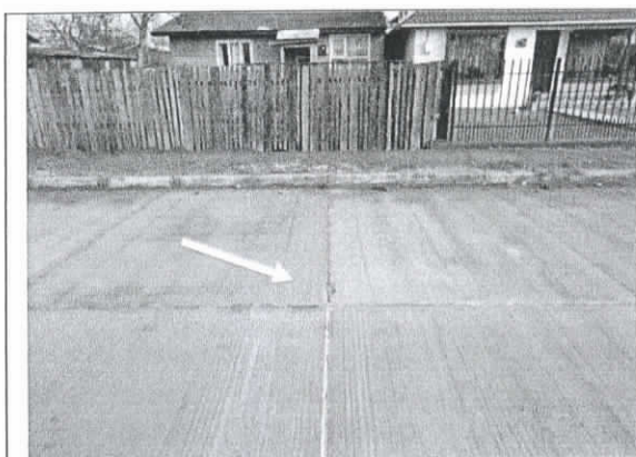
FOTO N° 30 DESCONCHE EN JUNTA DE PAVIMENTO
