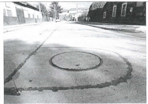
FOTO N° 17 TAPA DE CÁMARA A DESNIVEL
