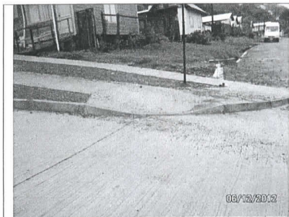
FOTO N° 1, SOLERAS SIN EMBOQUILLADO
