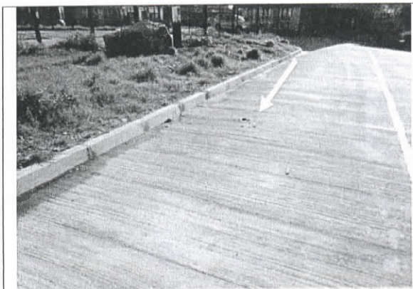
FOTO N° 22 PERFORACIÓN DE TESTIGO MAL TAPADO
