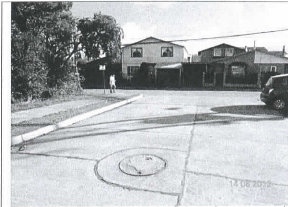
FOTO N° 18 TAPA CÁMARA CON HORMIGÓN DESGASTADO
