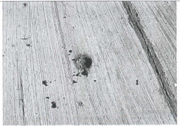
FOTO N° 23 PERFORACIÓN DE TESTIGO MAL TAPADO
