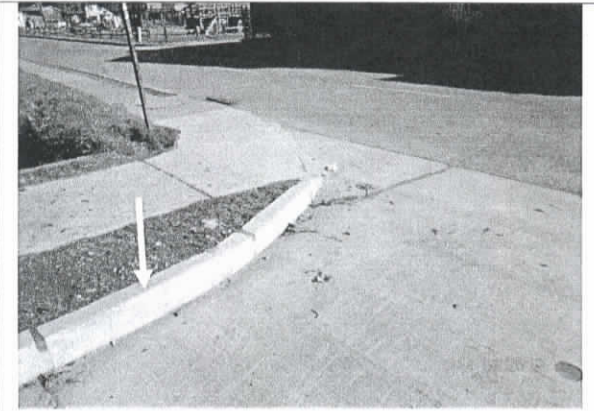
FOTO N° 21 SOLERAS RECTAS Y SEPARACION > 5 MM
