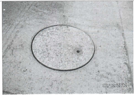
FOTO N° 12 TAPA CÁMARA CON HORMIGÓN DEFICIENTE
